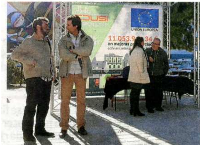
▲ Punto informativo en Torrent. El Ayuntamiento ha instalado una mesa informativa para los vecinos y comerciantes, a pie de las obras de urbanización de la calle Camí Reial. :: LP
