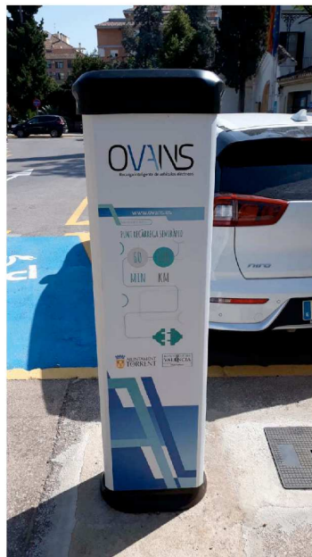
Puesto de recargas de vehículos eléctricos. EPDA
