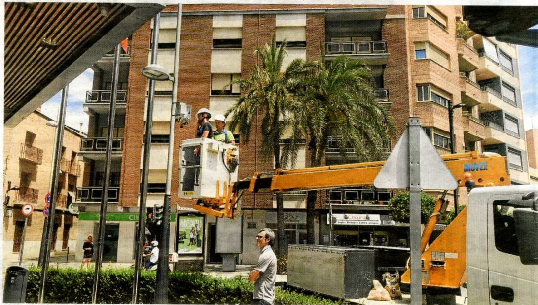
Unos operarios instalan los sensores para medir el ruido en una farola delante del ayuntamiento. :: A. D.
